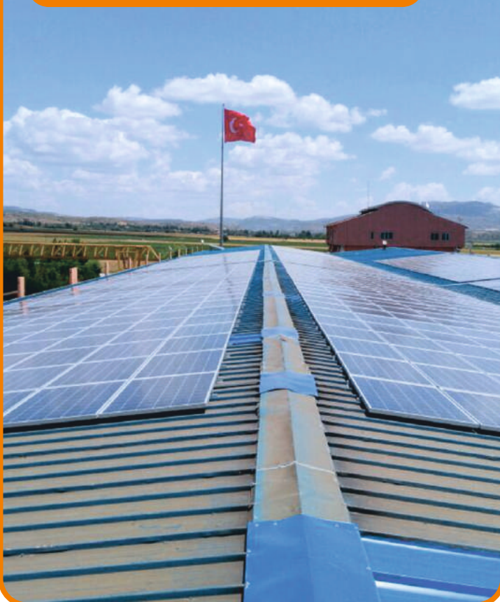
Ersan Galvaniz Çatı GES 1 MWp KAHRAMAN KAZAN ANKARA 2016
